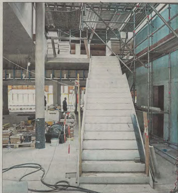
BAUSTELLE: Neben dem Eingangsbereich werden derzeit die Umkleiden und die Duschen saniert. Foto: Sandbiller
