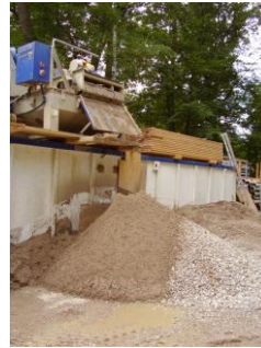
Förderleitungen für Trennung von Spülwasser und Sand-Kies
